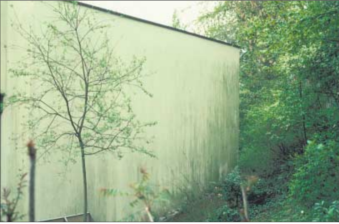
Wortwörtlich ein Haus im Grünen – Algenwachstum an einer Aussenmauer. (Bild Empa)
